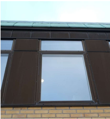
Vridfönster på västfasad.
