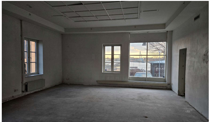
Det stora rummet på bottenvåningen, med synliga igengjutningar av håligheter i golvet efter gasverkets ursprungliga installationer.
